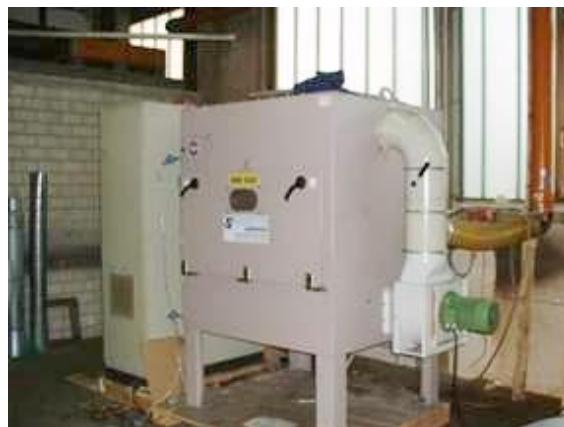
Abb. 1: Bild einer bestehenden Anlage
