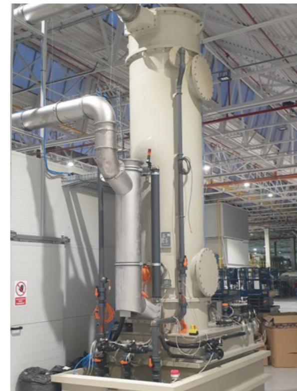
Anlage für 1 x 2.500 m 3 /h, in PP
