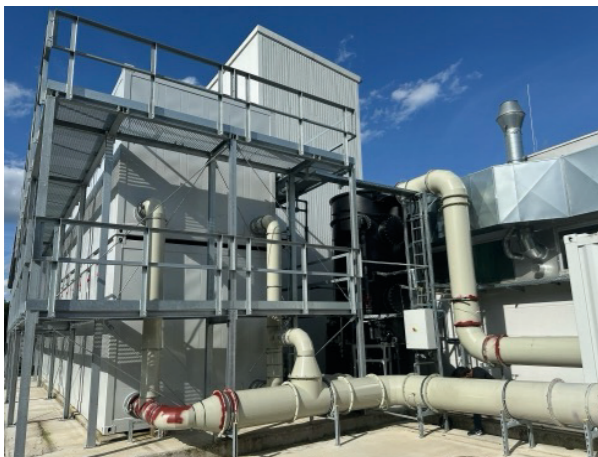
Industrieanlage für 10.000 m 3 /h Abgas
