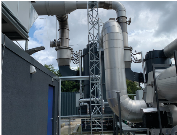
Beispiel für ein Abgassystem nach einer Batterieprüfanlage
