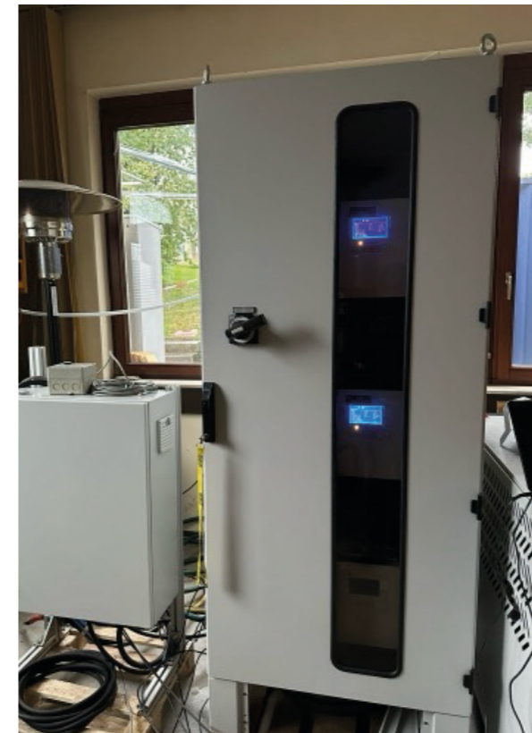
180 kW modular aufgebaute Stromversorgung
