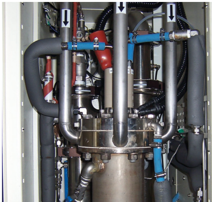
15 kW POU Plasmanlage zur Abluftreinigung in der Halbleiterindustrie
